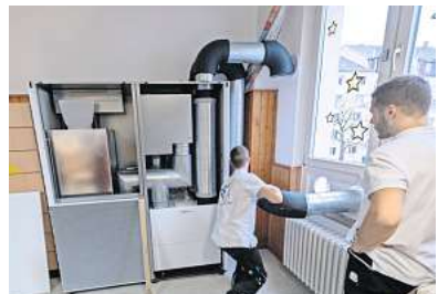
Fest installierte Lüfter sind nahezu geräuschlos. FOTO: TIM SCHAARSCHMIDT
