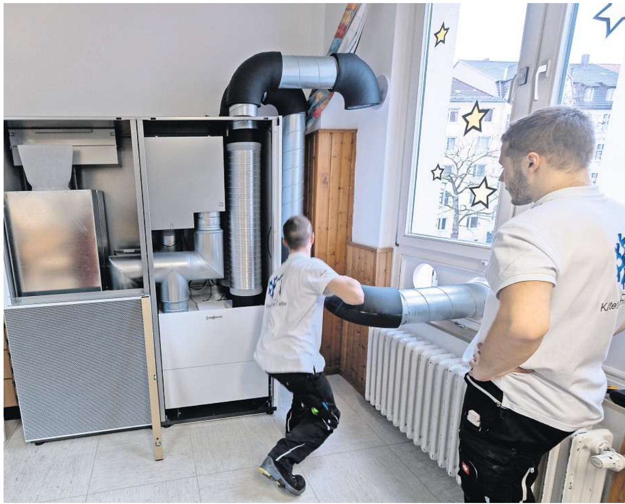
Die Lüftungsgeräte nehmen viel Platz im Klassenzimmer in der St.-Ursula-Schule weg. Deshalb hält Schulleiter Norbert Junker den Einbau in weiteren Räumen für schwierig. FOTO: TIM SCHAARSCHEIDT
